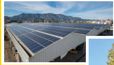
5MWp Kapasiteli Güneş Tarlası (Döşemealtı)
